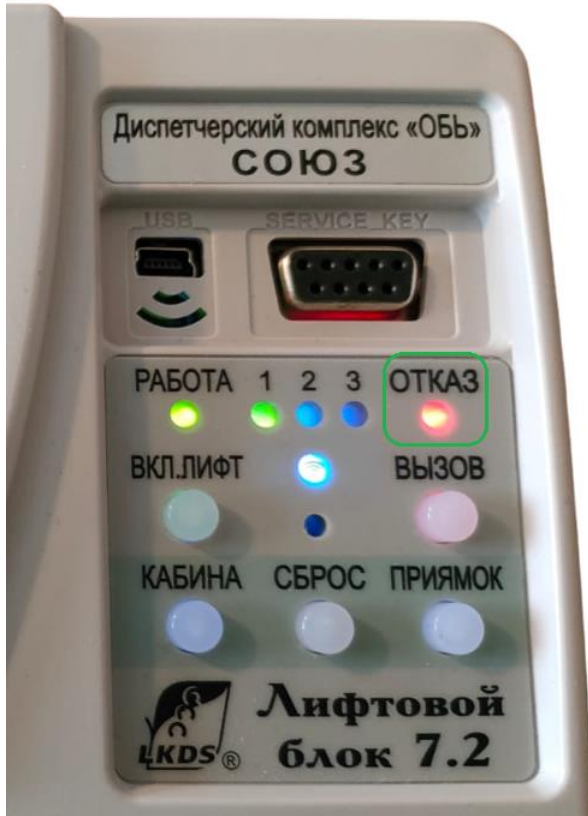
Состояние светодиода ОТКАЗ (горит) (при отсутствии связи ЛБ с СУЛ)
