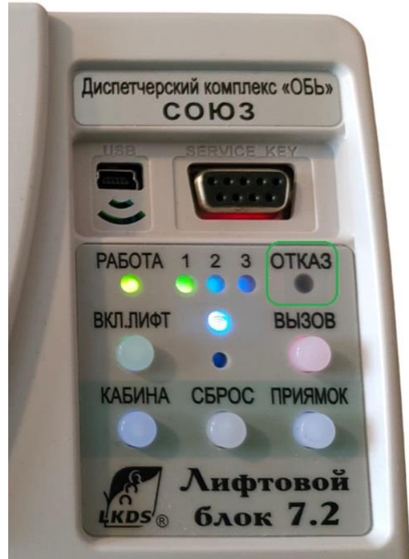
Состояние светодиода ОТКАЗ (не горит) (при отсутствии связи ЛБ с СУЛ)
